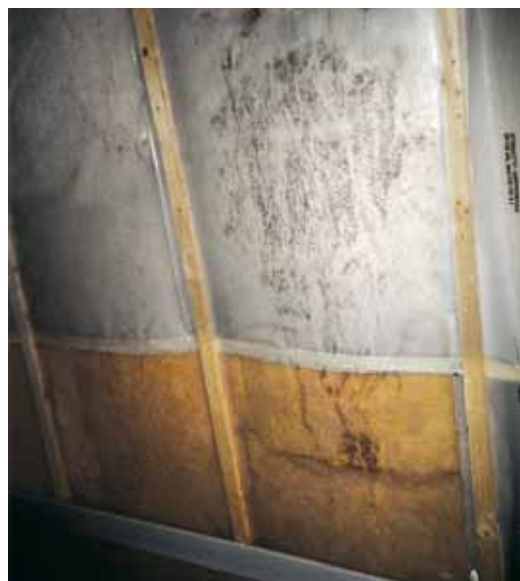
Aantastingen veroorzaakt door het plaatsen van vochtig hout in combinatie met een traditioneel dampscherm.
